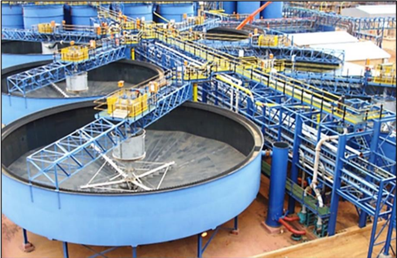
FIGURE 2.20 EXEMPLE DE CIRCUIT D'ÉPAISSISSEMENT
